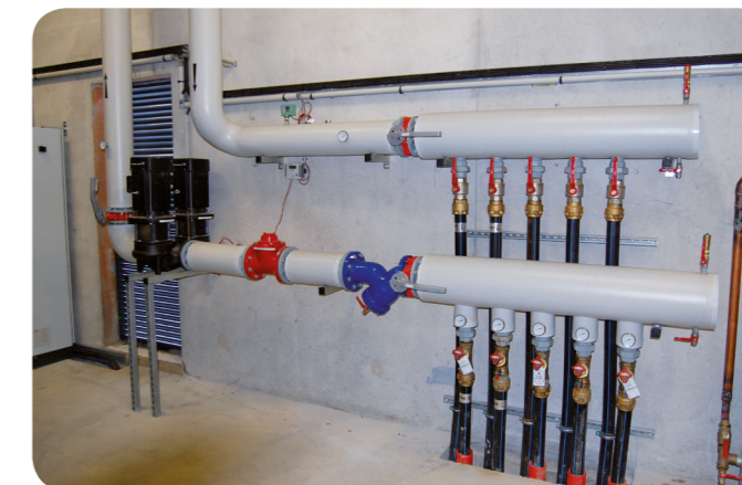
Chaufferie : départ des sondes géothermiques
